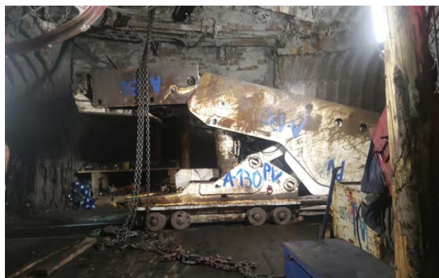
Sestava hidravličnega podporja na odkopu A k. -130 (foto: Klemen Mevc)
