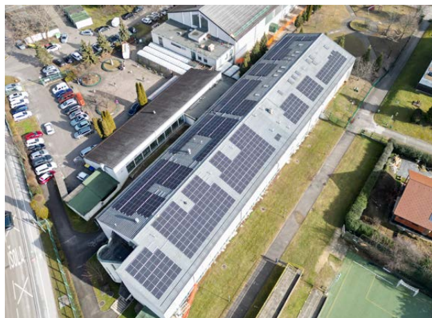
Osnovna šola Šalek Velenje (404,950 kWp)
