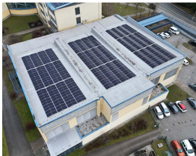
Osnovna šola Karla Destovnika–Kajuha Šoštanj (152,880 kWp)
