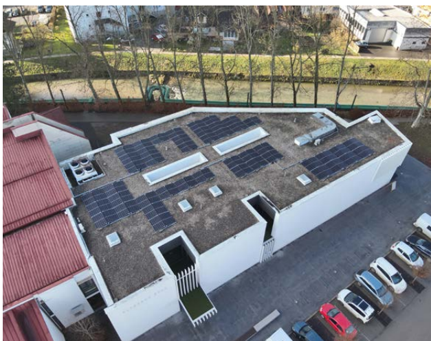
Glasbena šola Šoštanj (40,950 kWp)
