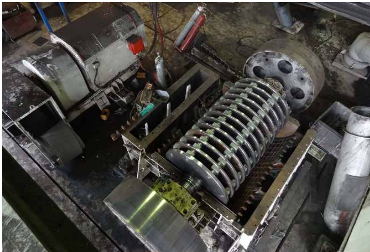
Po 28 letih delovanja sta bila oba udarna drobilnika premoga že močno dotrajana in potrebna obnove. (foto: Slavko Gros)
